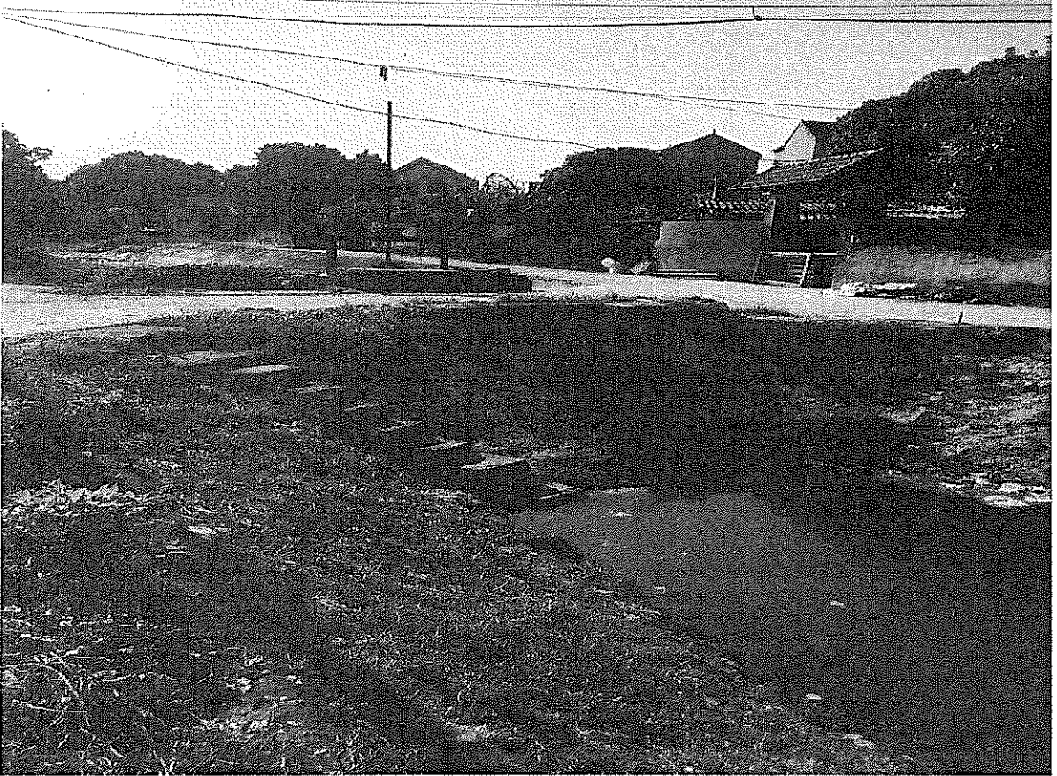
Hình 3,4: Cổng điều tiết trên kênh Bắc trạm bơm Xa Loan
