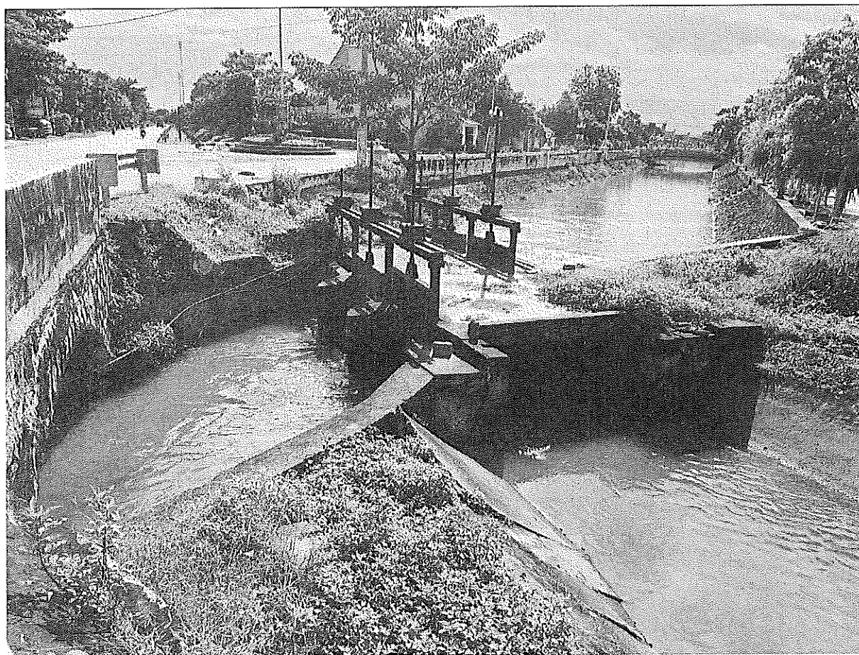
Hình 9: Công điều tiết Khe Niễng trên kênh Bắc trạm bơm Xa Loan
