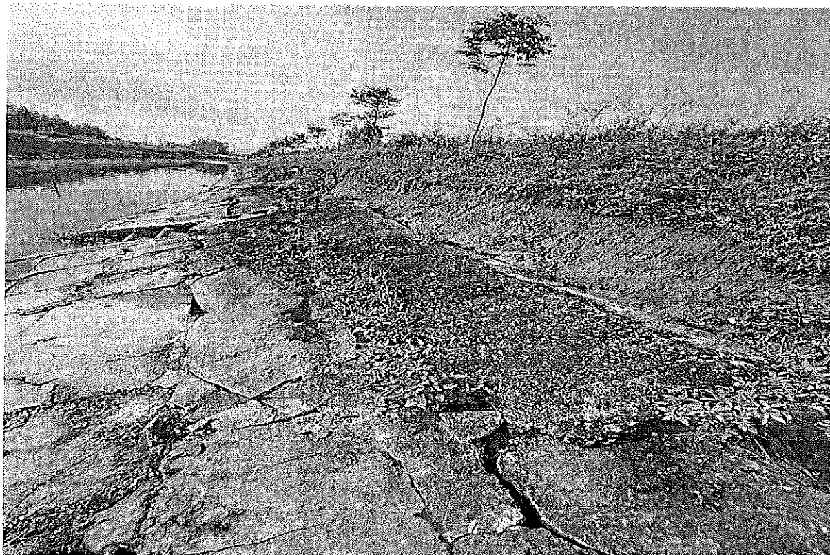
Ảnh hiện trạng bồi lắng tạo cơ đất đoạn K1+184÷K1+232.
