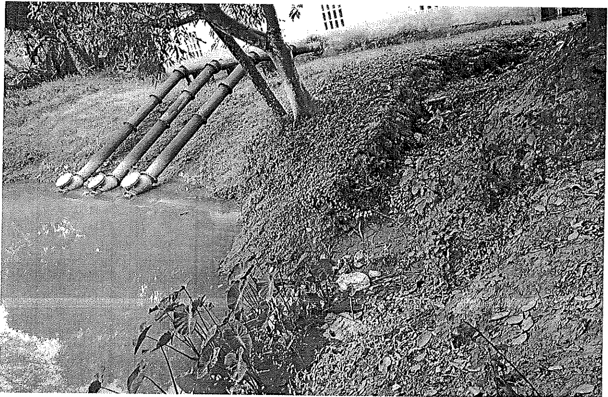
Bể hút TB Vạn Đề bị sạt.
