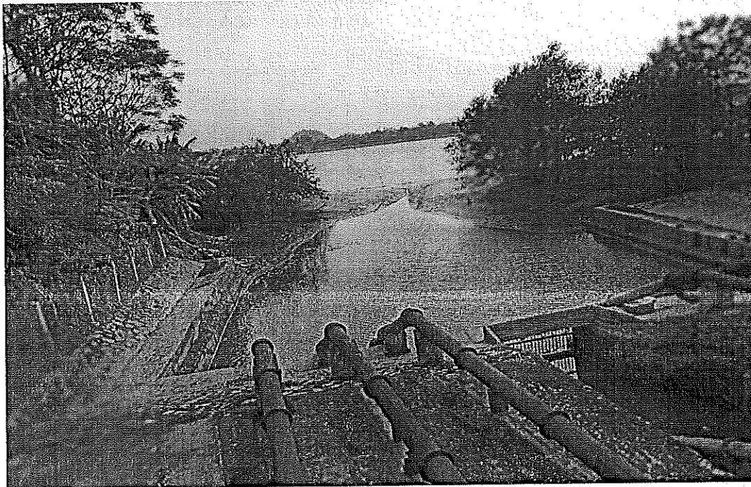
Ảnh hiện trạng kênh dẫn bể hút bị bồi lắng.
