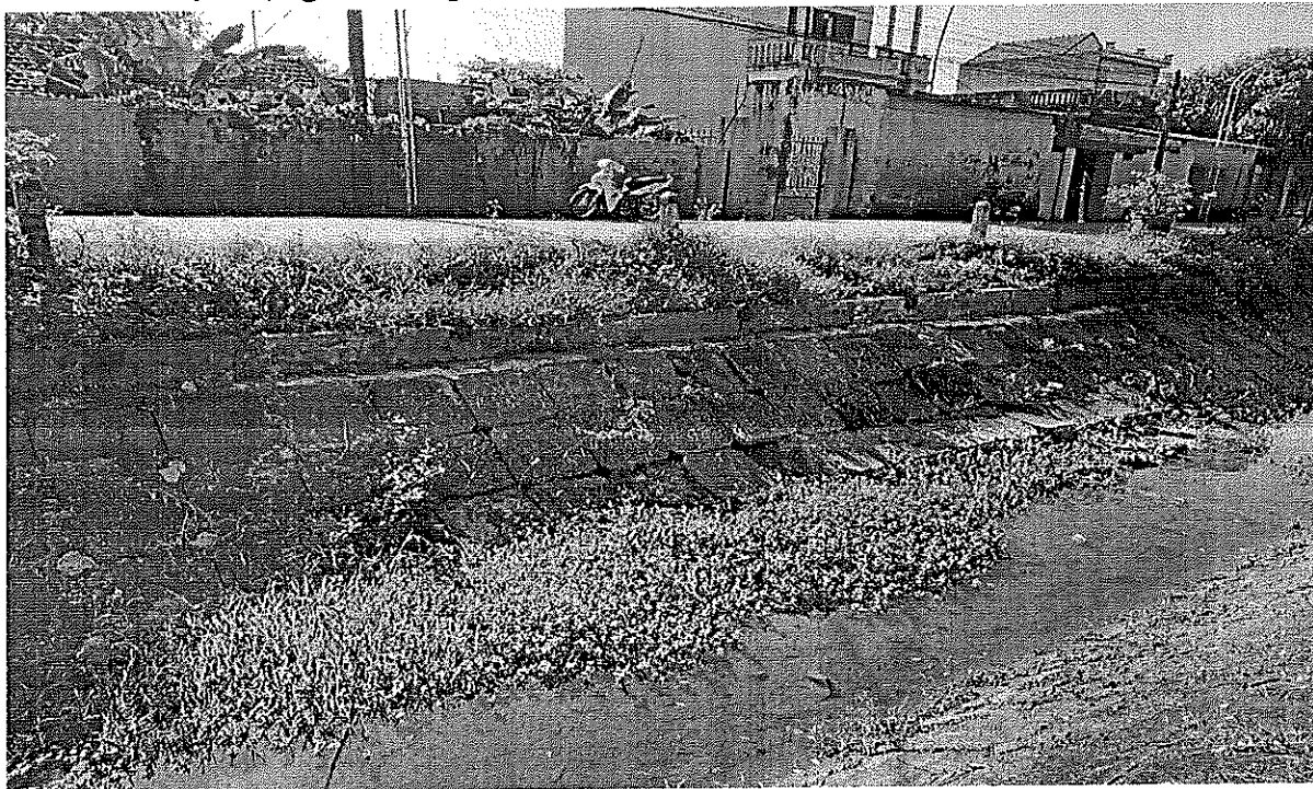
Sạt lở mái kênh TB Vực Bà.
