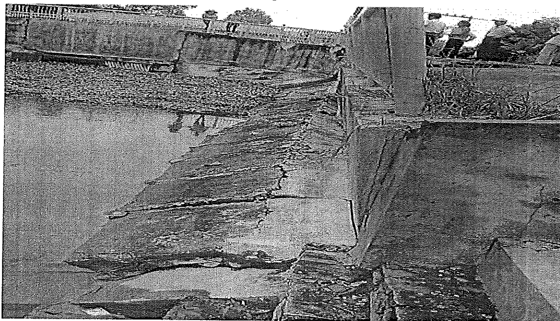
Ảnh hiện trạng mái kênh dẫn bể hút TB thôn Hậu bị sụt lún.
