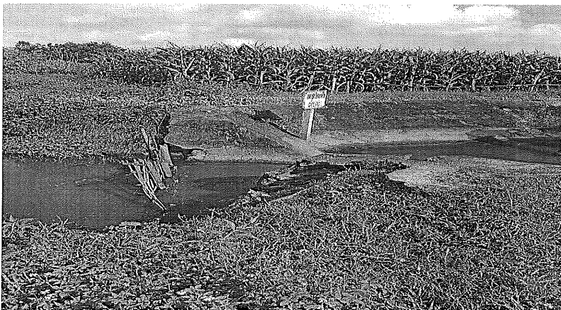
Ảnh hiện trạng bể hút bị hư hỏng.
