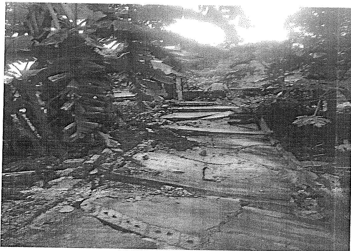
Tường rào bị đổ.
