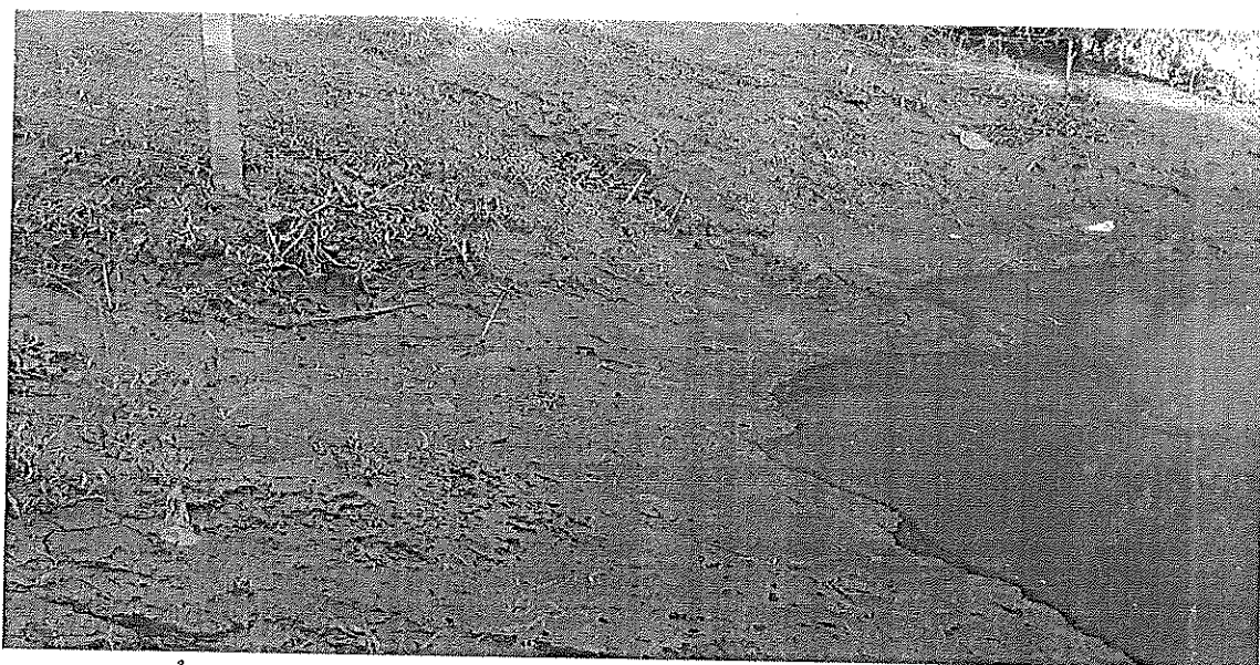
Ảnh hiện trạng kênh dẫn bể hút TB Thiệu Xá bị bồi lắng.
