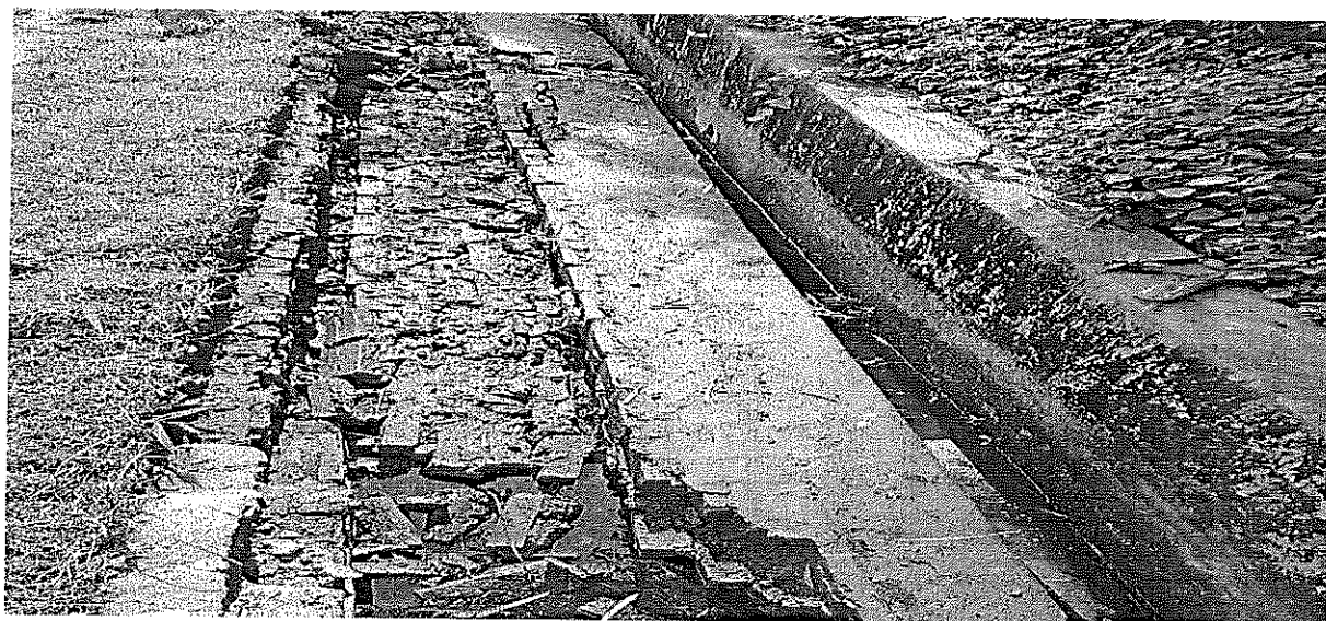
Ảnh hiện trạng đố tường kênh đoạn K22+00~K22+015.
