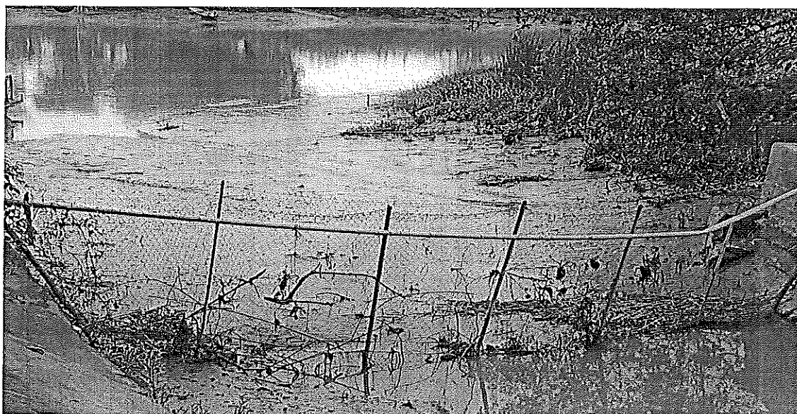
Ảnh hiện trạng kênh dẫn bể hút TB Quang Lộc bị bồi lắng.
